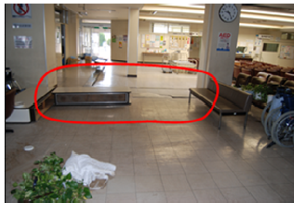
※北茨城市立総合病院(北茨城市) 本震(3/11)、余震(4/9)により地盤沈下を繰り返した土台への亀裂等複数病棟の使用停止、MRI等医療機器が損傷
