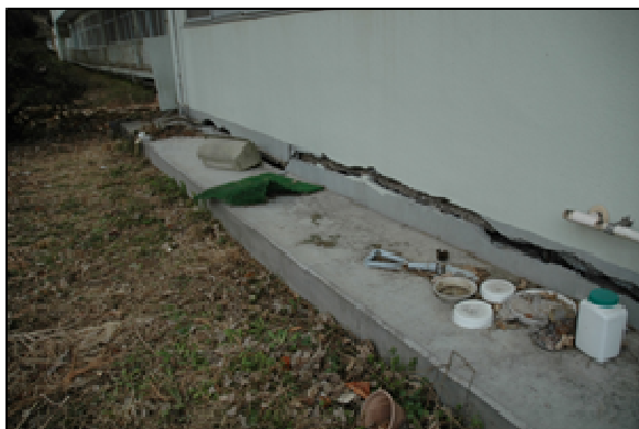
※日製日立総合病院(日立市) 土台への亀裂等複数病棟の使用停止、MRI等医療機器が損傷
